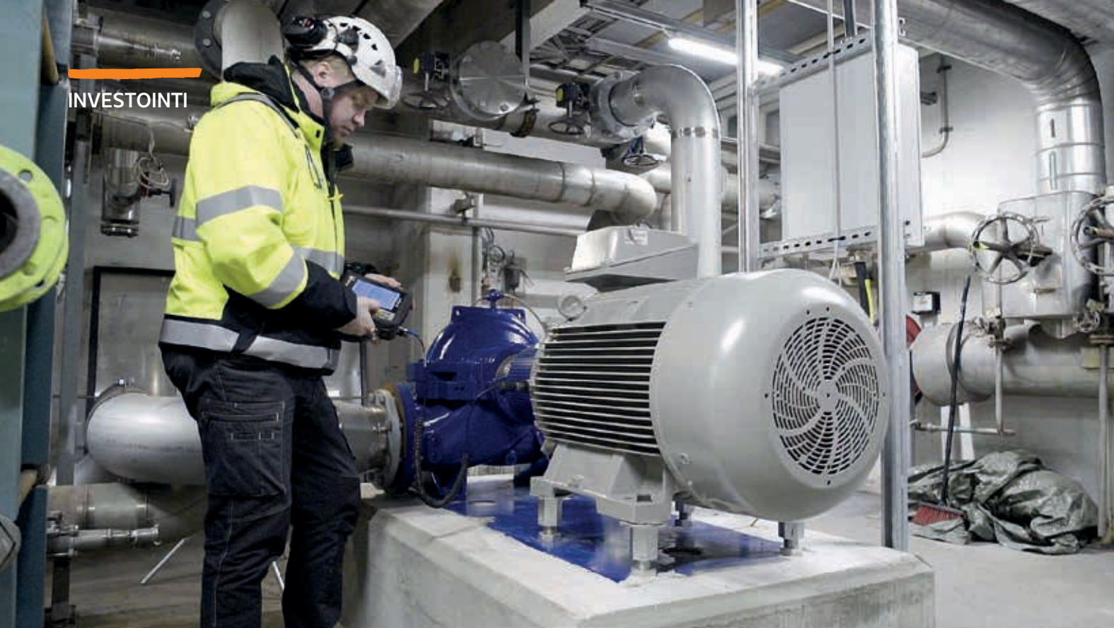
Vesilaitoksella toteutettu ratkaisu paransi laitoksen toimitusvarmuutta ja energiatehokkuutta. KUVA JOHANNES KARHULA
