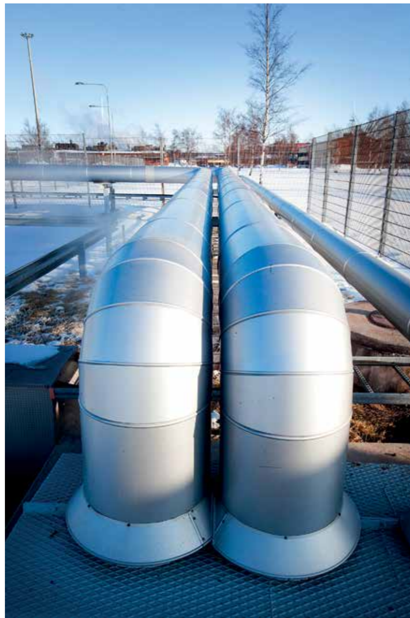
KIP:n alueella teollisilla synergioilla on pitkät perinteet. Ainevirtoja siirtyy alueella yrityksestä toiseen putkia pitkin. KUVA JORMA UUSITALO
